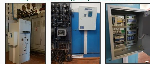
Монтаж в ЗРУ-3,3 кВ Монтаж в щитовой тяговой подстанции Внутренняя компоновка прибора
